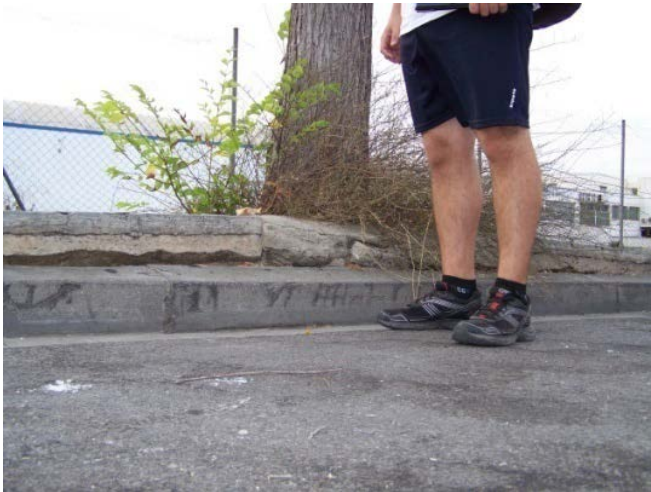
Fig. 22 i 23. Situacions anòmales i disfuncionals d'ubicació de cambres d'instal·lacions i de masses vegetals. Imatge estreta de la presentació de Serra, R., jornada REfabriCAT.2017, LITA-UPC
